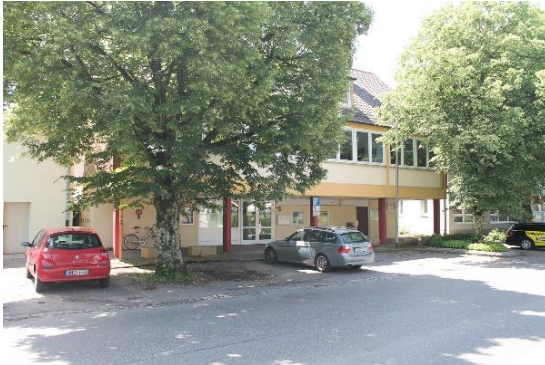
Abb. 4.4: Modernisierungsbedürftiges Gebäude, Ortsamt Schlechtbach, Rathausplatz, Haus Nr. 5 [WHS 2019]
