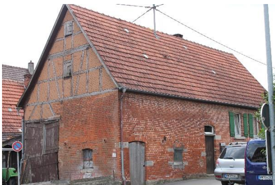
Abb. 4.2: Umfassender Modernisierungsbedarf bzw. Abbruch und Neubau, Schmale Straße, Haus Nr. 16 [WHS 2019]
